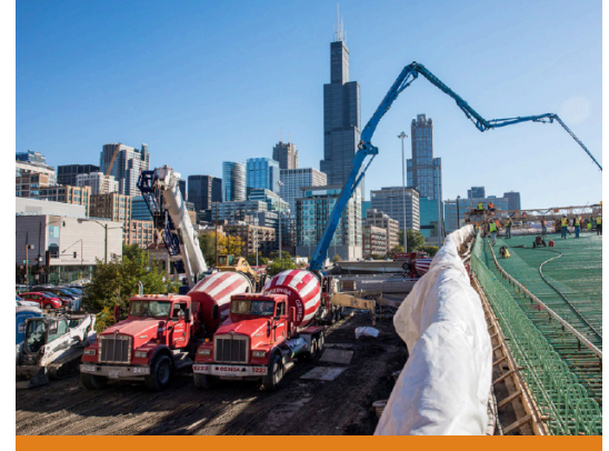
Le béton prêt à l'emploi Ozinga produit du béton minéralisé en CO 2 via CarbonCure depuis 2016.
